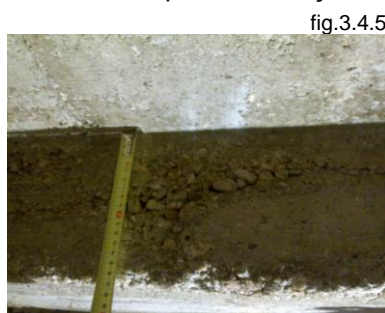
Defecte de execuție. Planșeu peste o grindă segregată din beton armat
