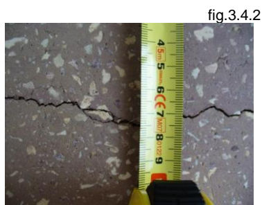
Fig. 3.4.2 Fisură cu deschidere medie (0,5–2 mm), placă balcon
