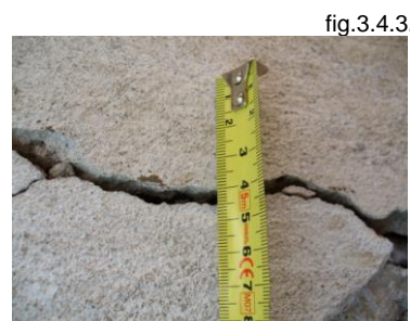
Fig. 3.4.3 Fisură cu deschidere mare ( >2 mm), stâlp din beton armat
